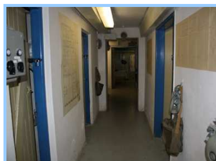
Chodba a technické místnosti
